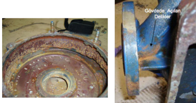
Şekil 6. Deniz suyu basan bir pompada galvanik korozyon
